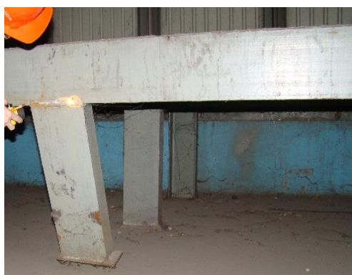
Рисунок 14 – Искривление упора под платформу между колоннами В12' – В13'
